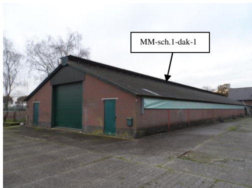
Foto 1: Geïnvventariseerde schuur 1 met asbesthoudende golfplaat als dakbedekking vanuit noordelijke richting gezien.
