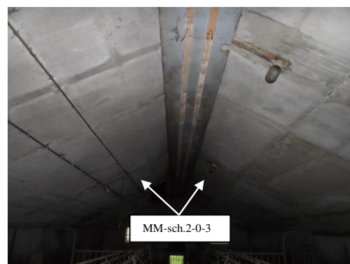
Foto 4: Asbesthoudend plaatmateriaal aan plafonds van schuur 2.
