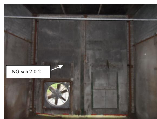
Foto 6: Asbesthoudend plaatmateriaal op deuren in schuur 2.
