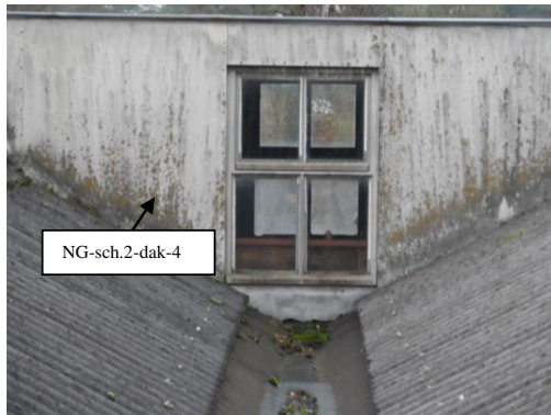
Foto 13: Asbesthoudend plaatmateriaal aan gevel t.p.v. middengang van schuur 2.
