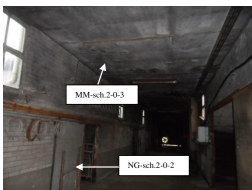
Foto 5: Asbesthoudend plaatmateriaal aan plafond in schuur 2. Tevens asbesthoudend plaatmateriaal op deur zichtbaar.
