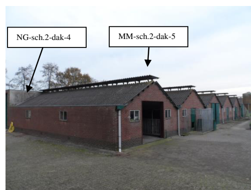
Foto 10: Geïntervieweerde schuur 2 met asbesthoudende als dakbedekking vanuit zuidelijke richting gezien. Tevens asbesthoudende gevelbeplating zichtbaar t.p.v. middengang.
