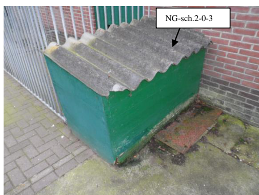
Foto 9: Asbesthoudende golfplaat op hondenhok naast schuur 2.
