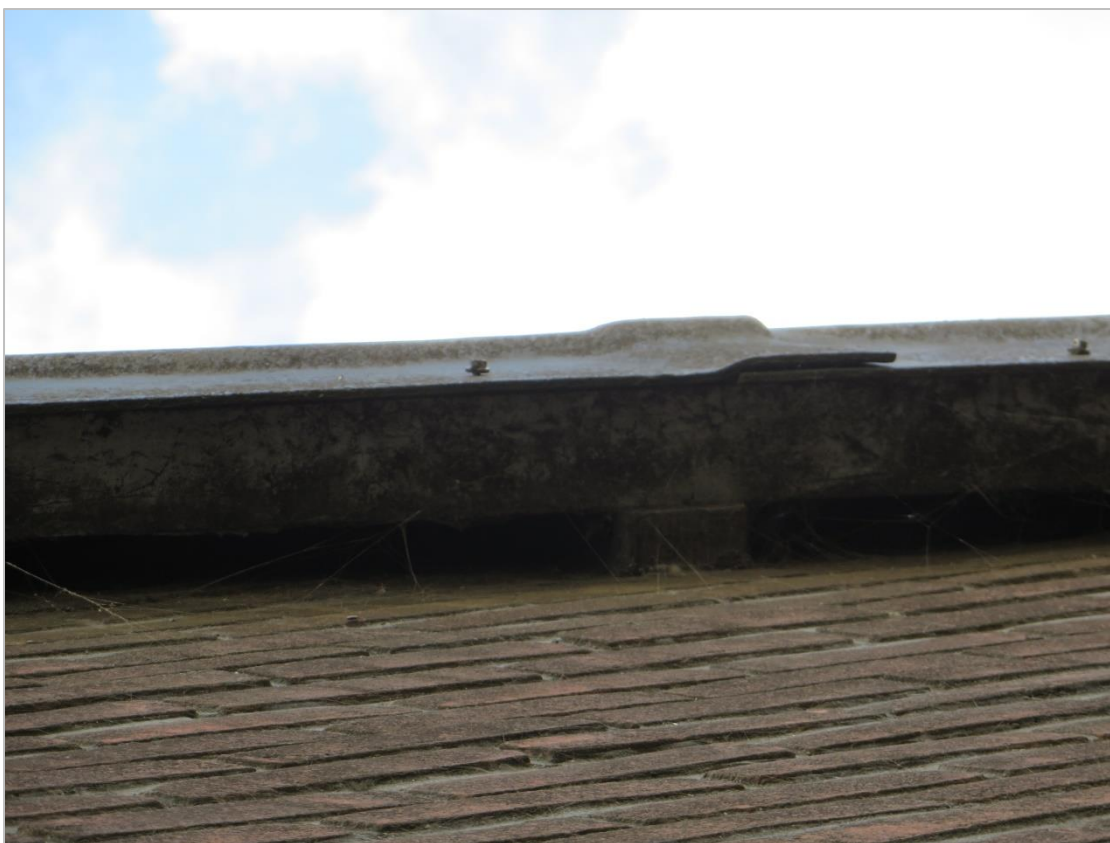
Afbeelding 4-2. De kier tussen de gevel en balk. Er is duidelijk te zien dat er veel spinnenrag in de kier aanwezig is. Foto: Natuurkompas, 2014.
