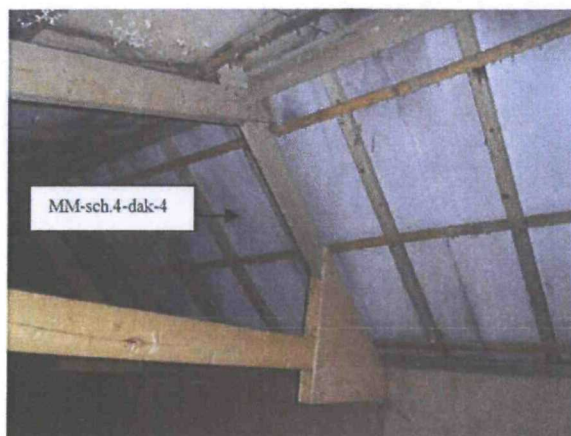
Foto 7: Asbesthoudend plaatmateriaal als gedeeltelijk dakbeschot van schuur 4.
