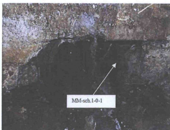
Foto 2: Asbesthoudend buismateriaal in fundering/gevel van schuur 1.
