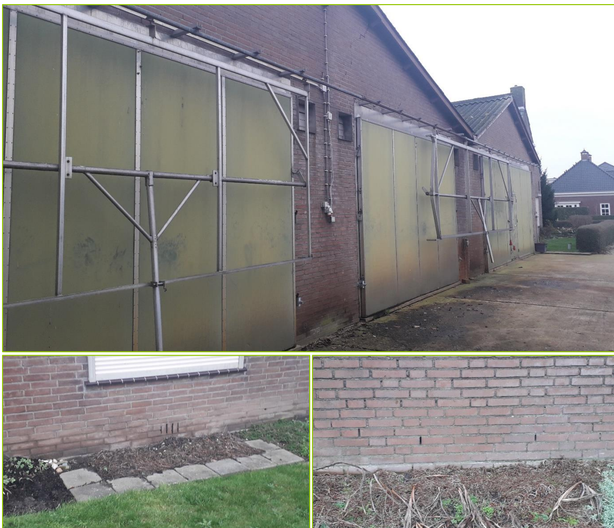
Figuur 3 In de gevels van de koelcellen (boven) zijn geen openingen aanwezig, benevens enkele stootvoegen zeer laag bij de grond (onder).
