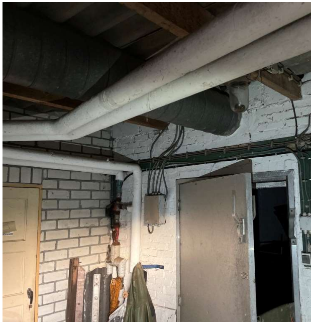
Binnenzijde gebouw links, losse golfplaten in gang
