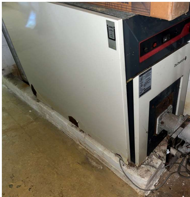
Binnenzijde gebouw rechts, c.v. installatie
