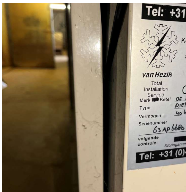
Binnenzijde gebouw rechts, c.v. installatie
