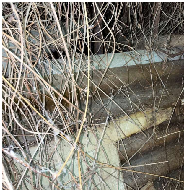
Binnenzijde stal gebouw links, losstaande golfplaat
