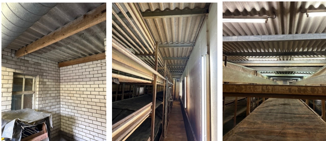
Foto 1: situatie rechte schuur incl. constructie Foto 2-3: de asbestplaten als plafondbeplating op de stalen liggers.
