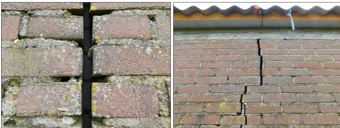
Foto 11 en 12. Spleten in de muur aan de achterzijde van de kapschuur die vleermuizen toegang verlenen aan de ruimte in de spouwmuur.
