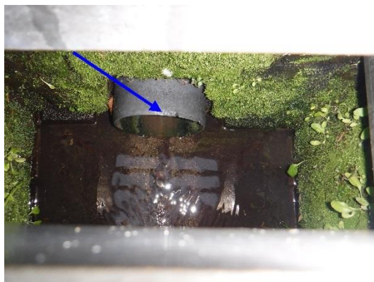
Foto 28 | Pvc afvoer in de put buiten
