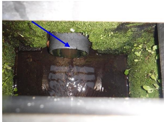
Foto 28 | Pvc afvoer in de put buiten
