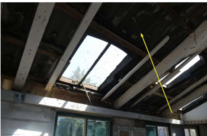
Foto 26 dakpannen, niet onderschoten
