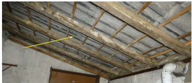
Foto 33 niet onderschoten dakpannen
