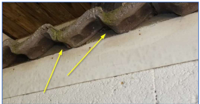
Foto 29 afdicthing golven onder dakpannen
