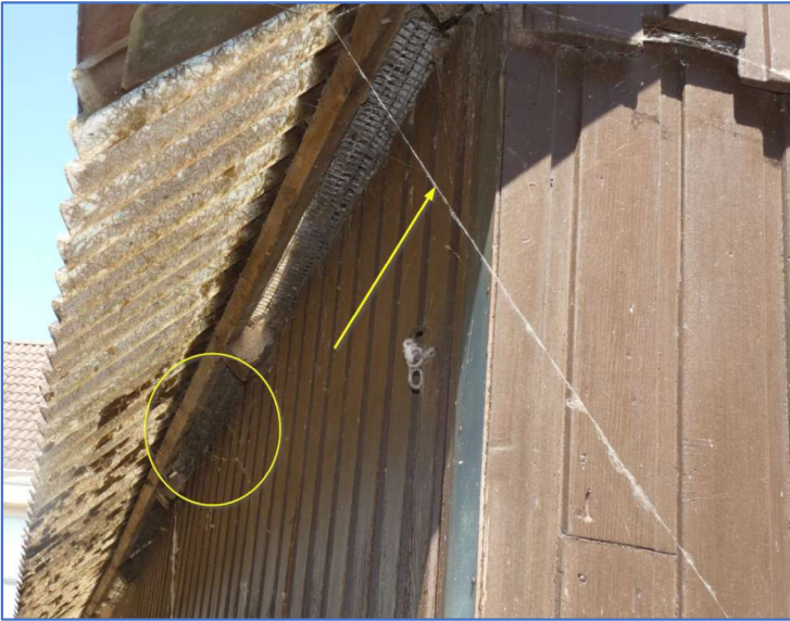
Foto 58 spinnenrag buitenzijde NO gebouw 2
