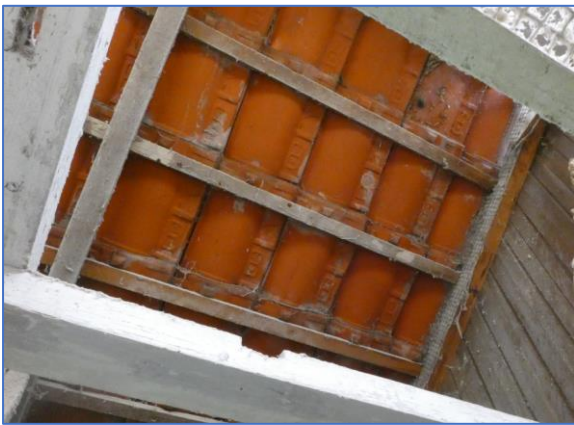
Foto 19 niet onderschoten dakpannen
