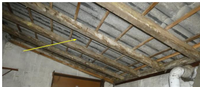
Foto 33 niet onderschoten dakpannen
