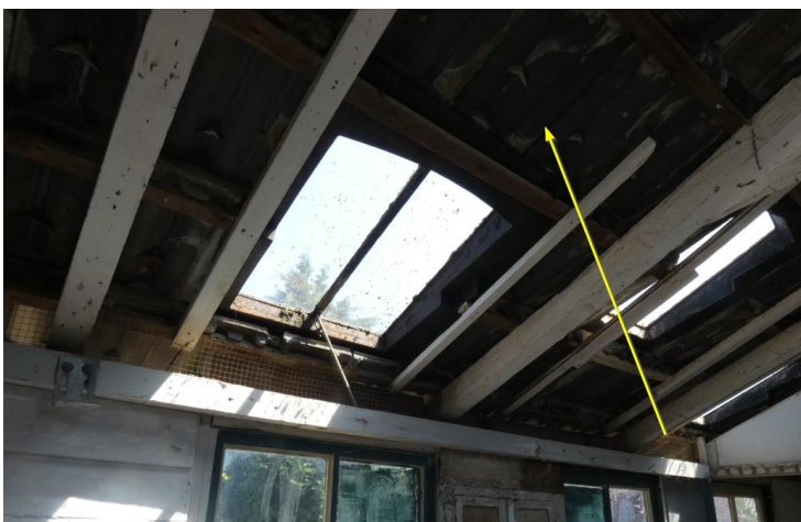
Foto 26 dakpannen, niet onderschoten
