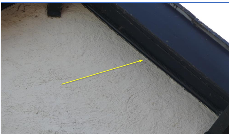
Foto 49 Dak-overstek gebouw 1 a W
