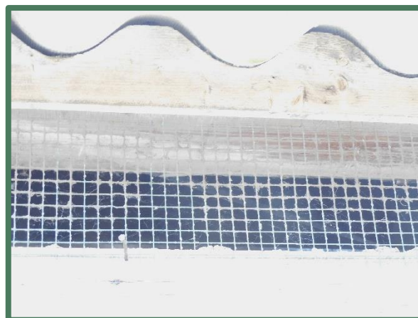
Afgesloten dakrand en luchtinlaat
