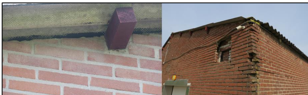
Figuur 5 Stal 2 bevat kieren bij het dakoverstek en missende bakstenen waardoor de luchtspouw toegankelijk is voor vleermuizen, en het voorkomen van verblijfplaatsen niet uitgesloten kan worden.
