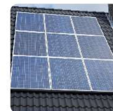
Zonnepanelen in een afgeronde vorm ...
