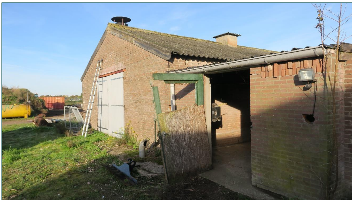
Figuur 3 In loods 2 zijn er kierende windveren met voldoende grootte aanwezig voor gebouwbewonende vleermuizen.
