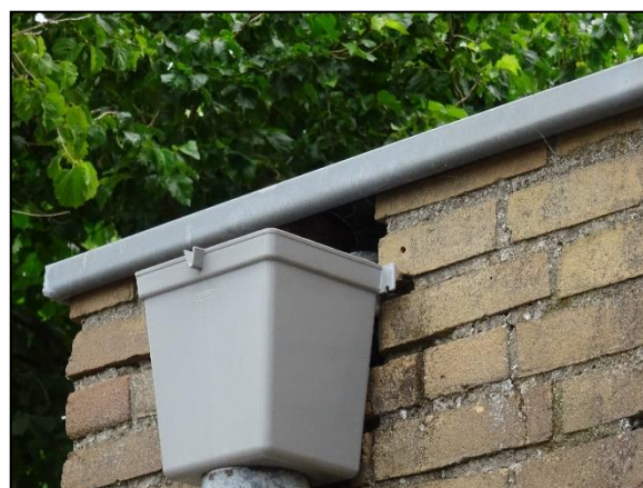
Figuur 10. Opening boven de afvoer bij de garage.
