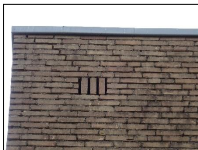
Figuur 11. Aanwezige open stootvoegen in de bebouwing welke toegang kunnen verlenen tot de spouwmuur.
