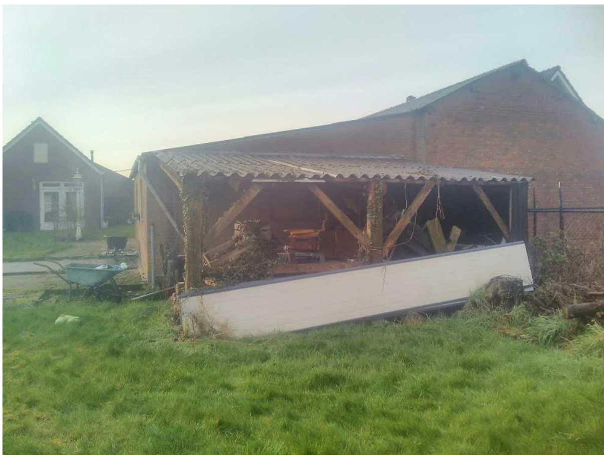
Foto 6 : aanbouw met asbesthoudend dak
