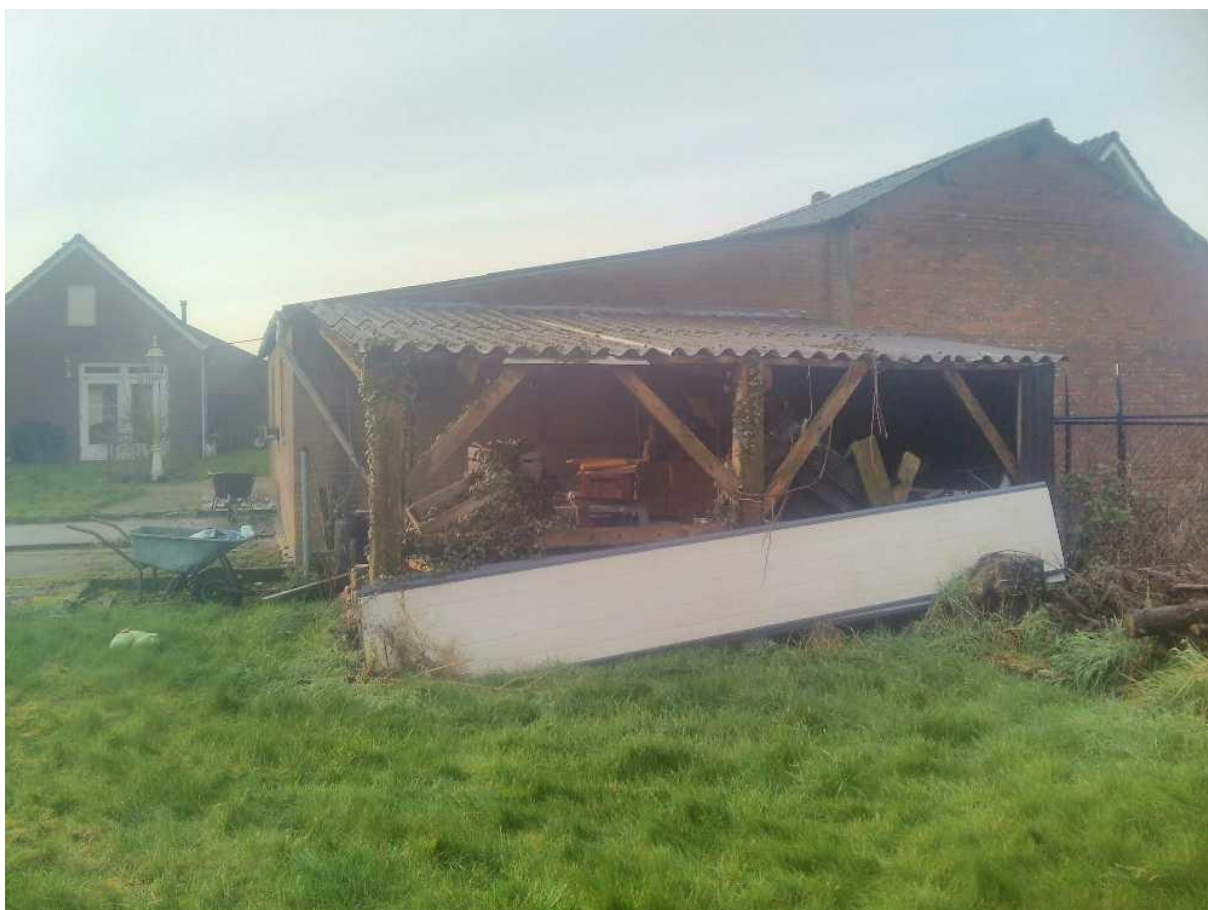
Foto 6 : aanbouw met asbesthoudend dak
