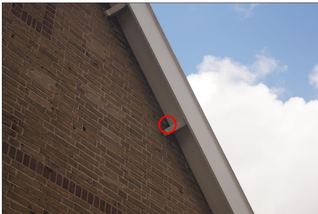
Figuur 4 De gebruikte opening waar een huismus uit kwam vliegen tijdens het veldbezoek. In de overige bebouwing zijn geen andere openingen meer aangetroffen.
