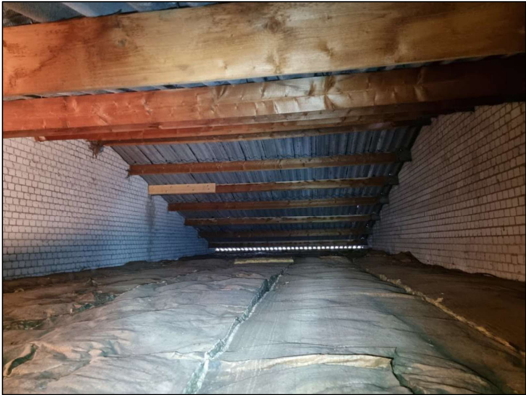
Figuur 3 De zolderruimte van de te saneren schuur met zichtbaar volledig ontbrekend dakbeshot.
