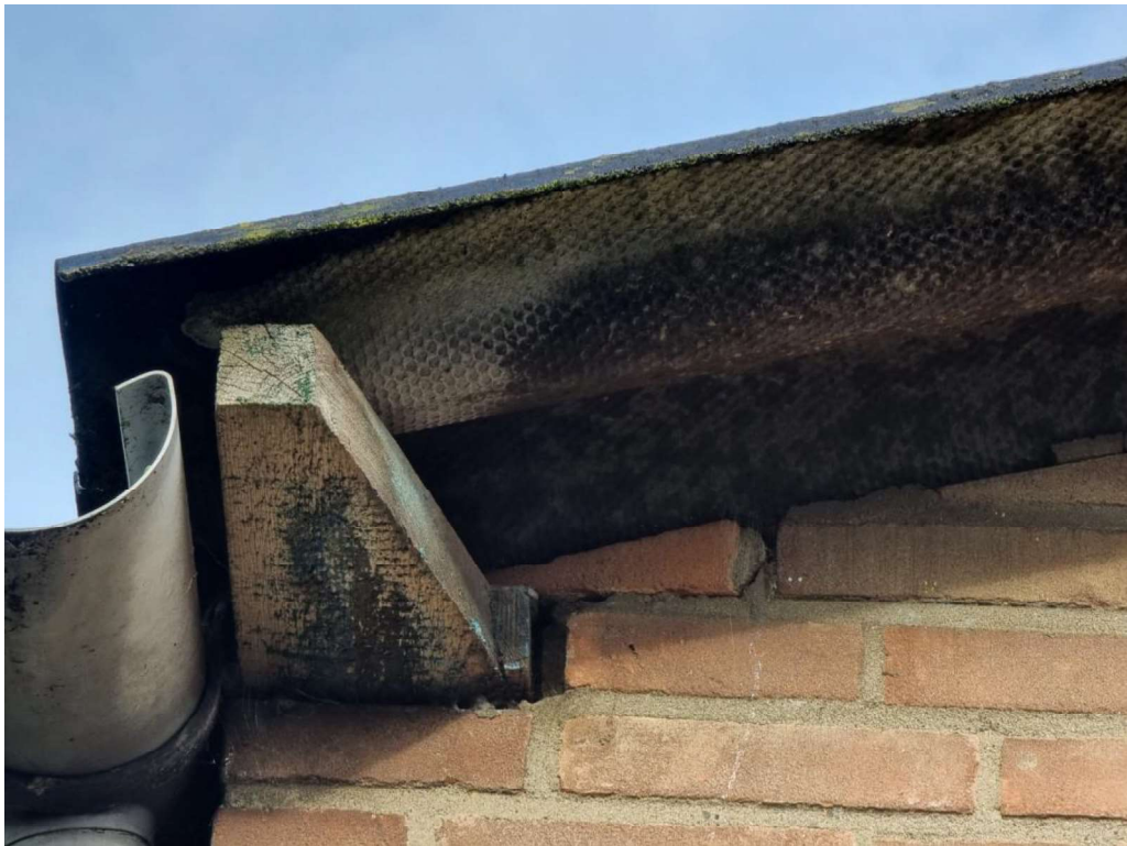
Figuur 4 De gevels en dakranden bevatten op verschillende plaatsen openingen waarmee vleermuizen toegang tot de spouwruimte geboden wordt.
