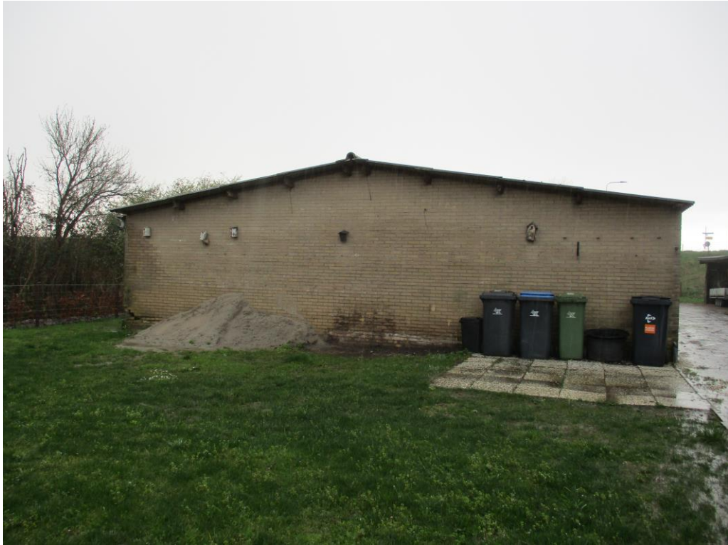
Figuur 5 De schuur (B) is ontoegankelijk doordat het dak direct aansluit op de stenenmuren.
