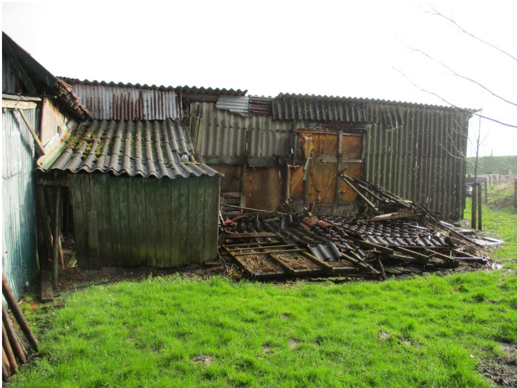
Figuur 6 De achterzijde van de schuur met overkapping (C en D) is gedeeltelijk ingestort.
