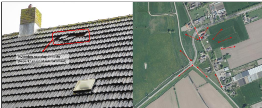
Figuur 4 De enige opening aan in het dak van de woning (A) is erg groot waardoor er geen geschikt microklimaat aanwezig is. Daarnaast zijn er ongunstige vliegroutes (rode pijlen) van en naar het plangebied aanwezig waardoor aanwezigheid van vleermuizen niet wordt verwacht.
