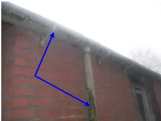
Foto 16 | Pvc goot en afvoer
