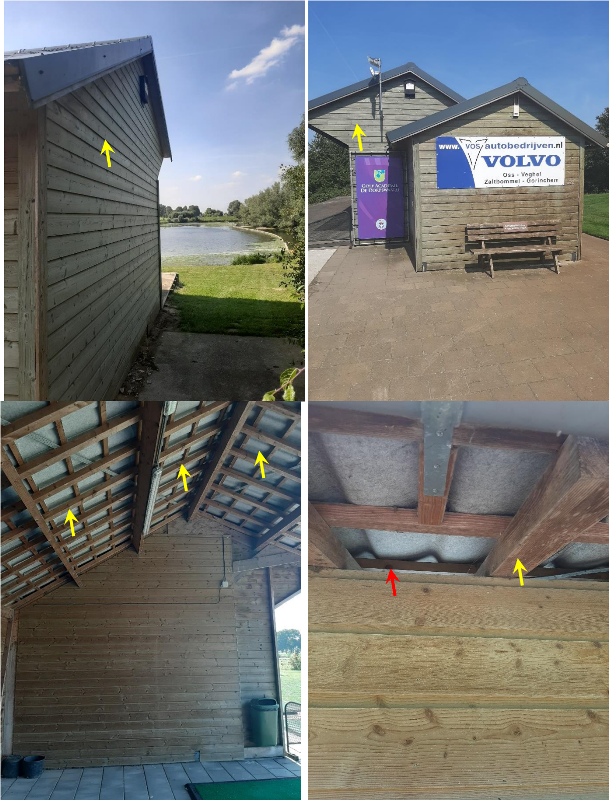
Figuur 4.4 Boven locatie van de plaatsing gevelbetimmering. De vloermuiskasten worden tegen de nok aan geplaatst en daaronder wordt de gevelbetimmering aangebracht. Onder, locatie van de te plaatsen platen tegen de tengellatten (gele pijl). Tussen de dakplaat en de tengellatten ontstaan compartimenten van 5cm bereikbaar voor vleermuizen via opening bij rode pijl.
