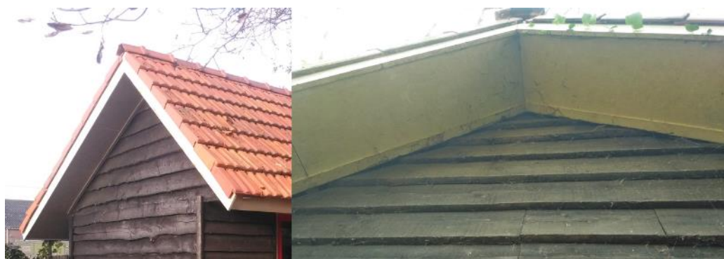
Figuur 3 De nok van het tuinhuis is open, de dakpannen en planken sluiten allen goed aan. Voor de openingen tussen de planken en het overstek is veel spinrag aanwezig (rechts).
