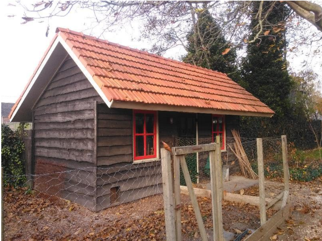
Figuur 3 Het tuinhuisje is opgetrokken uit houten planken en een zadeldak met dakpannen en een overstek. Er is geen dakgoot aanwezig.
