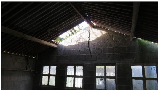
Foto 5. Gat in het dak van de te slopen schuur
