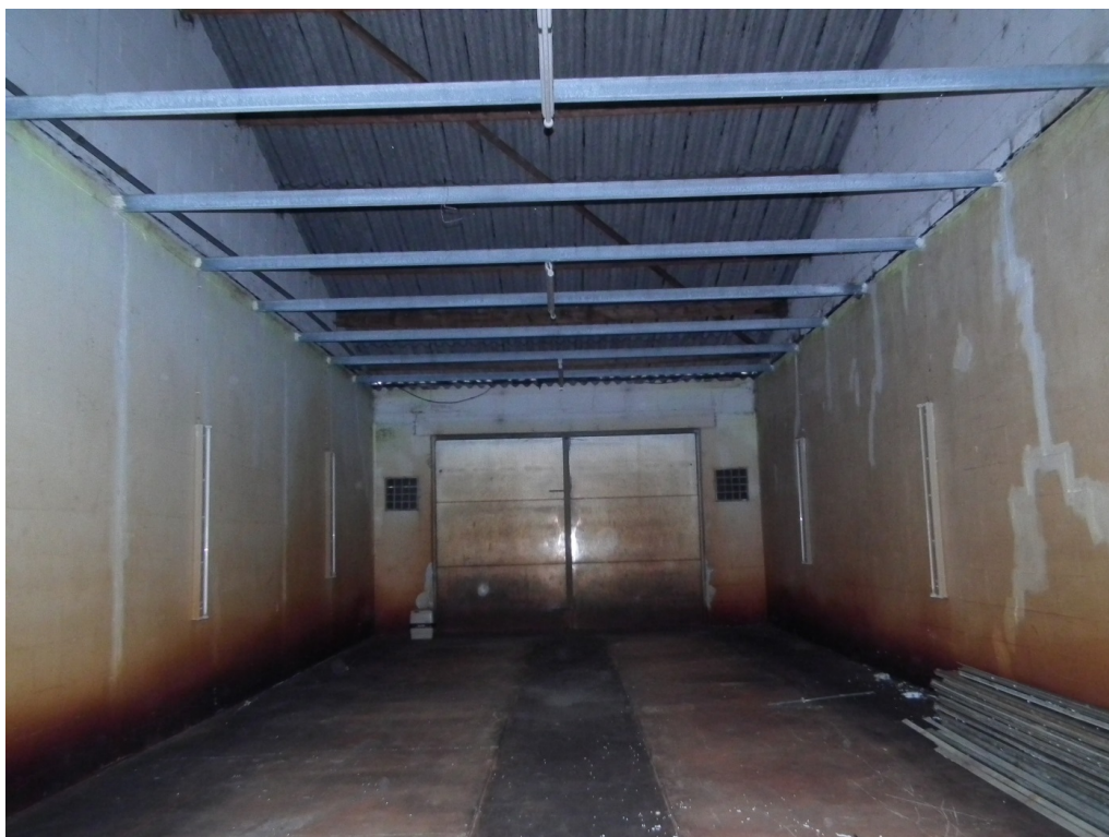
Figuur 3 De te slopen schuur bestaat uit gemetselde muren en een dak van golfplaten. De schuur is aan de binnenzijde geïsoleerd.
