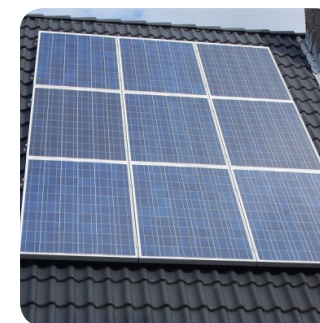
Zonnepanelen in een afgeronde vorm ...
