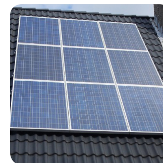
Zonnepanelen in een afgeronde vorm ...
