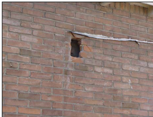
Foto 5. Gat in de muur van het pand
