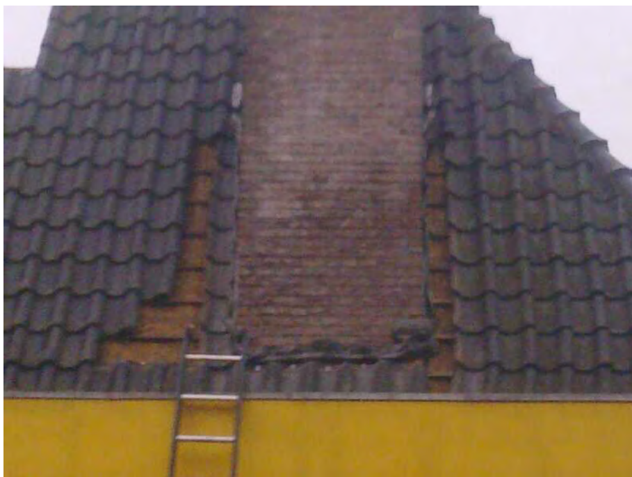
Foto 1: verwijderde pannen en loodslab langs de schoorsteen
