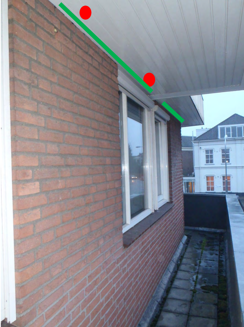
Foto 2: overkapping op de eerste etage. In de schroten moeten gaten worden gemaakt rood (indicatief) of de schroten moeten worden losgetrokken groen lijn (indicatief).
