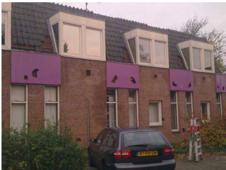
Foto 2: de gaten in de paarse betimmeringen en de verwijderde pannen op de nok en langs de dakkapellen
