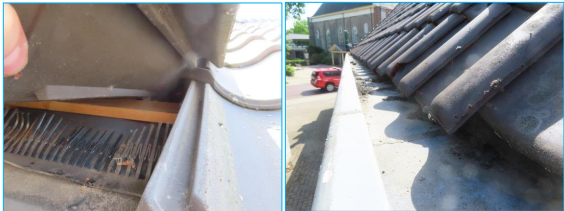
Foto's: Vogelschroot nieuwe deel, ongeschikte constructie oude deel. Beiden goed te onderzoeken met ladder.
