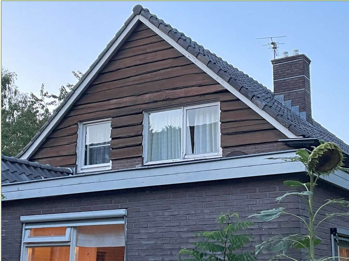
Figuur 6. De verweerde houten planken aan de gevel waarachter het verblijf van 3-4 gewone dwergvleermuizen kon worden aangetoond.
