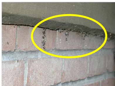
Figuur 5.4 Vleermuisuitwerpselen achter de gevelbetimmering.
