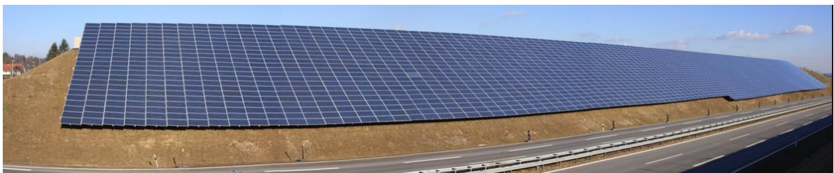
Afbeelding 18: Zonne installatie langs de a94 dicht bij Togg
