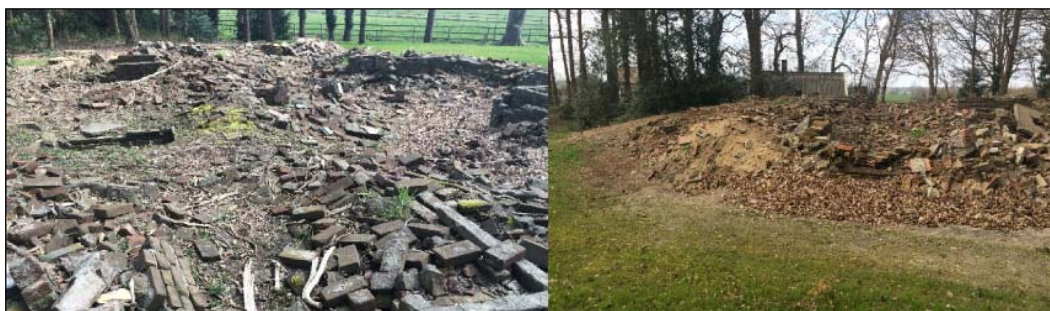
Puin- en funderingsresten afgebrande woning
