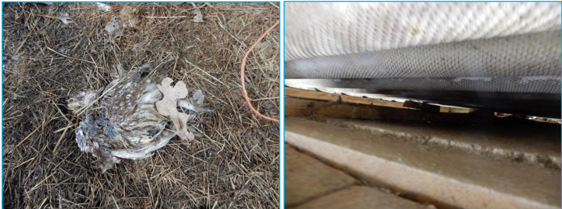
Foto's: Dode steenuil in stal 2 en goed te onderzoeken ruimtes achter isolatiepanelen.
