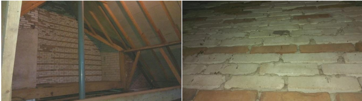
Figuur 1 en 2 Uitwerpselen vleermuizen op de zolder van het te slopen woonhuis
