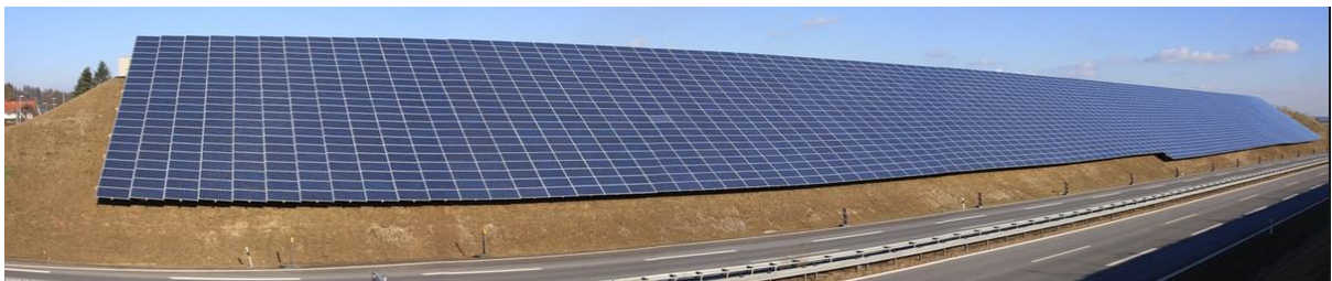
Figuur 4: Zonne installatie langs de a94 dicht bij Toting
