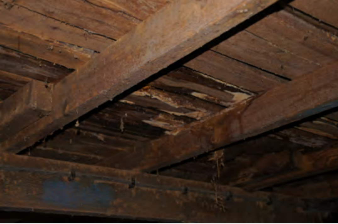
Close-up slechte staat binnenkant plafond
