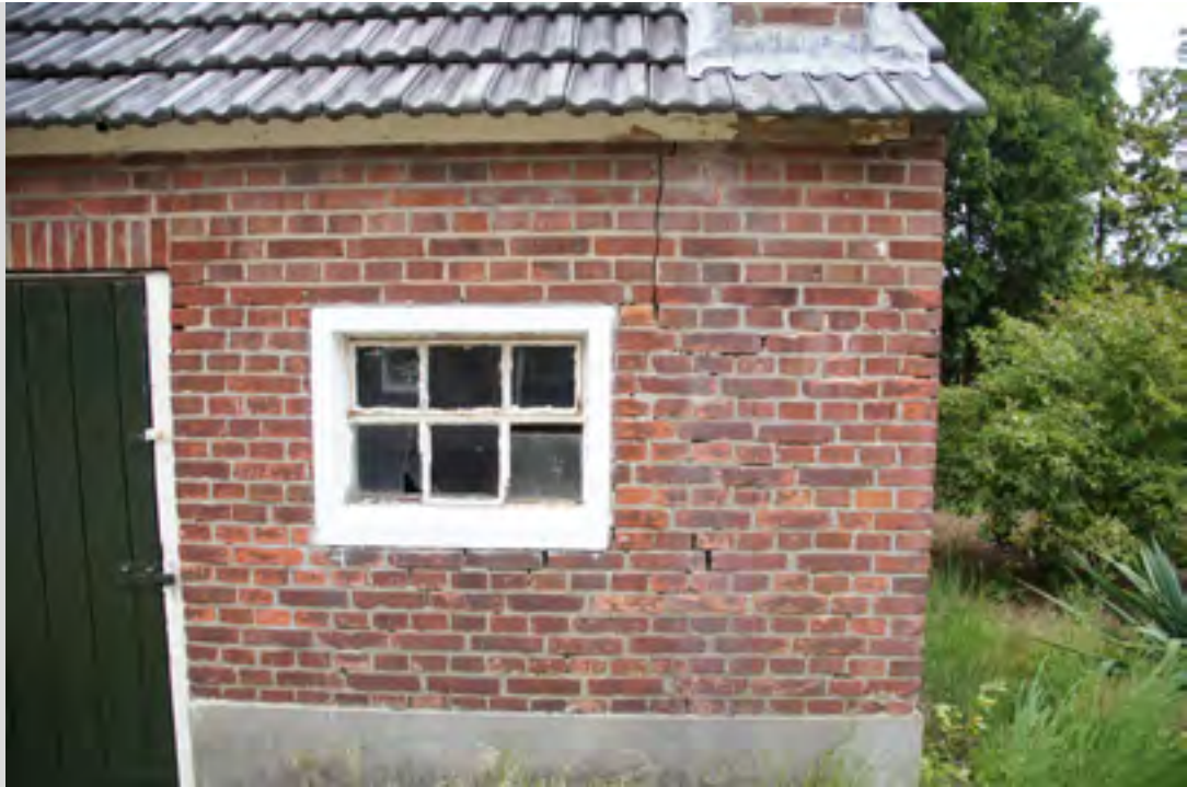
Close-up van de slechte staat kleinvee stal
