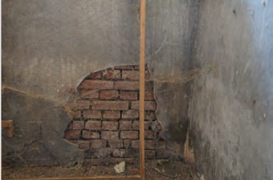
Close-up slechte staat binnenkant muur
