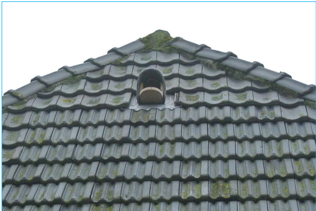
Foto: Loden dakpan met daarachter een kerkuilenkast (bron: Vogelwerkgroep Noordwest-Achterhoek).
