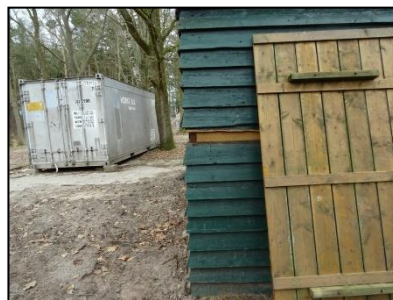
Figuur 14. Ontbrekende planken op 1 meter hoogte is ongeschikt voor vleermuizen als verblijfplaats.
