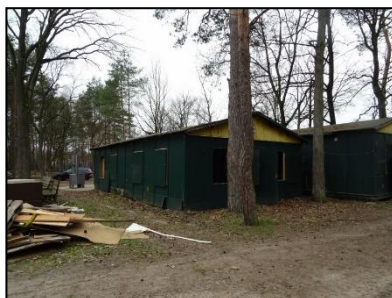
Figuur 7. Twee barakken (gebouw 4 en 5) in vervallen staat.
