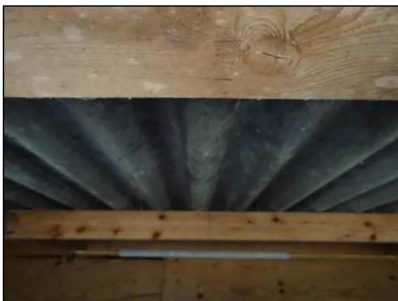
Figuur 10. Bij een deel van de golfplaten van de kantine ontbreekt het aan dakbeschot.
