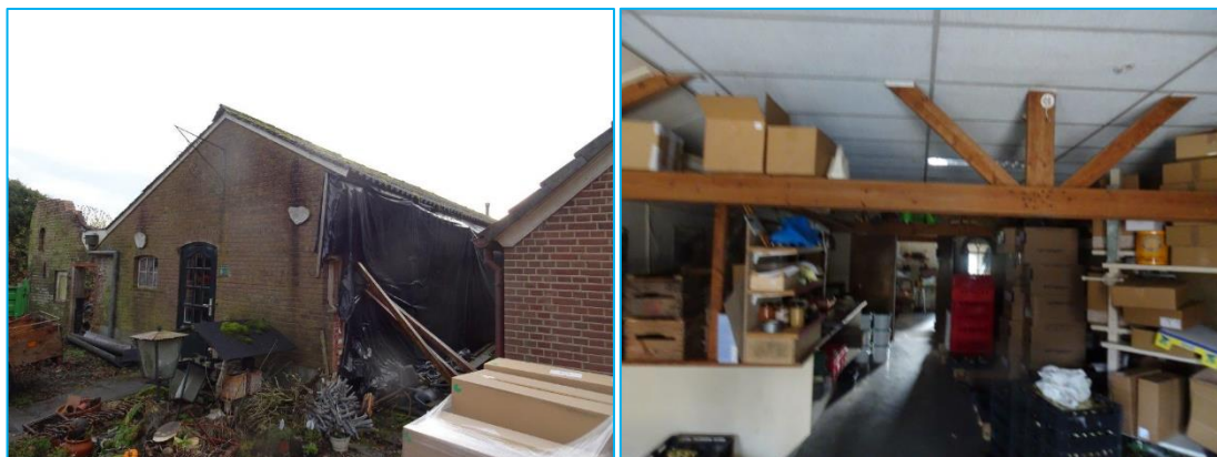
Foto's: Indrukken plangebied. Vervallen winkel/ aanbouw.
