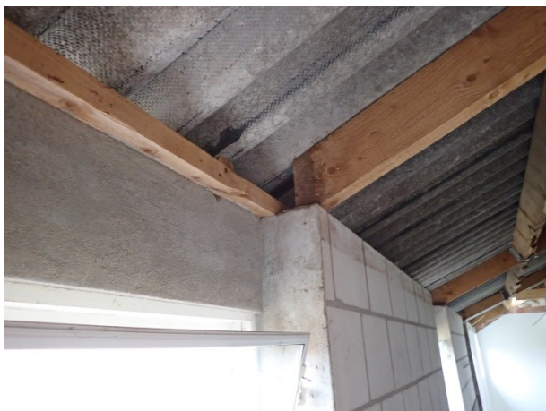
Foto 9: detail van de grote varkensstal (f) de kantplank die de spouw aan de bovenzijde afdicht.
