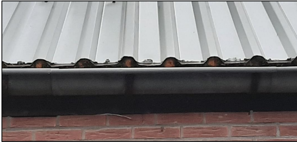
Figuur 6 Purschuim onder het dak van gebouw C.
