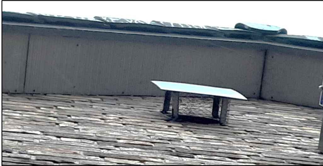
Figuur 5 Kieren onder de kantpannen van het dak van gebouw A.
