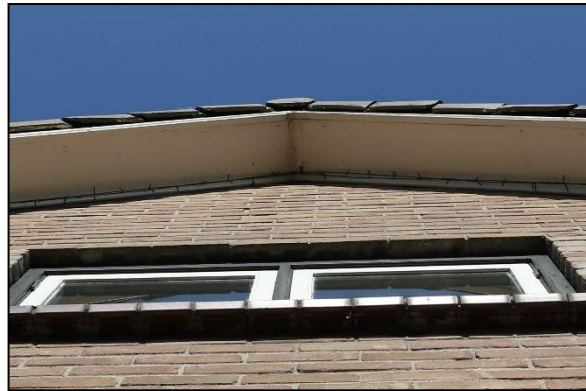
Figuur 17. Dakranden met openingen.
