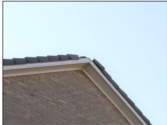
Figuur 15. Nokpan ontbreekt op noordwest zijde woonhuis.
