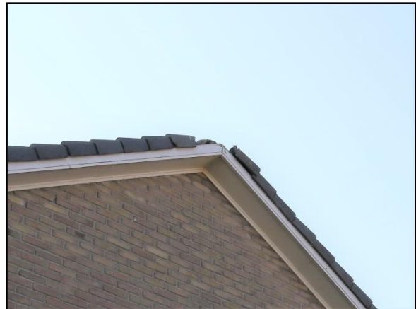
Figuur 15. Nokpan ontbreekt op noordwest zijde woonhuis.
