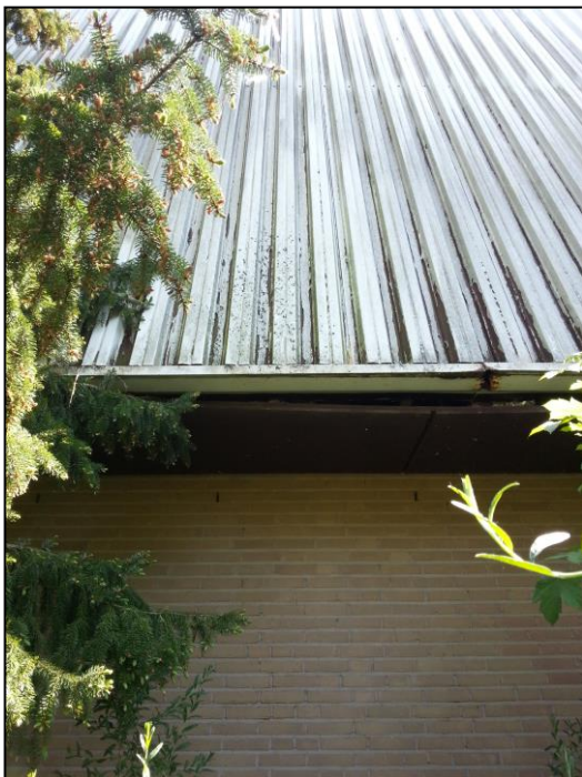
Foto 2: Losgekomen houten daklijst
