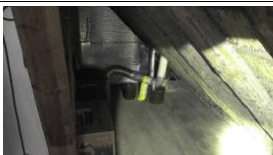
Ventilatie en rookgasafvoer kleine woning op zolder hoofd woning.
