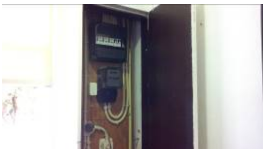
Meterkast kleine woning (geen asbestverdachte toepassingen).
