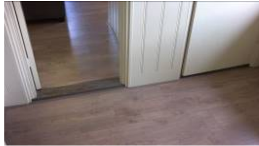
Onder laminaat woonkamer en keuken hoofdwoning kale dekvloeren.
