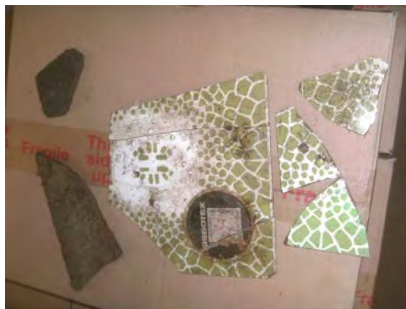
Foto 17: Asbesthoudende vloertegels uit inspectiegat 7
