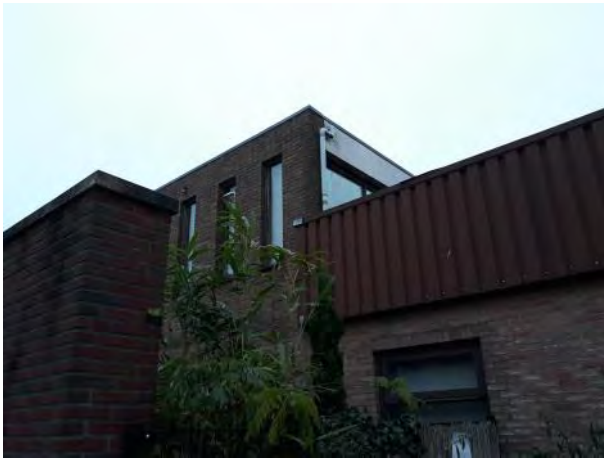
Hoger kantoorpand B, met open stootvoegen en witte gevelplaten.
