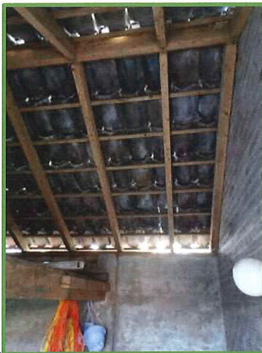
Dakbeschot niet aanwezig
